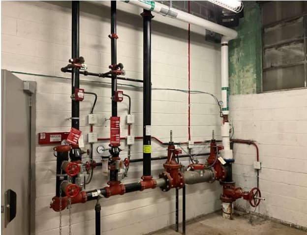
31 - FIRE SPRINKLER RISERS
